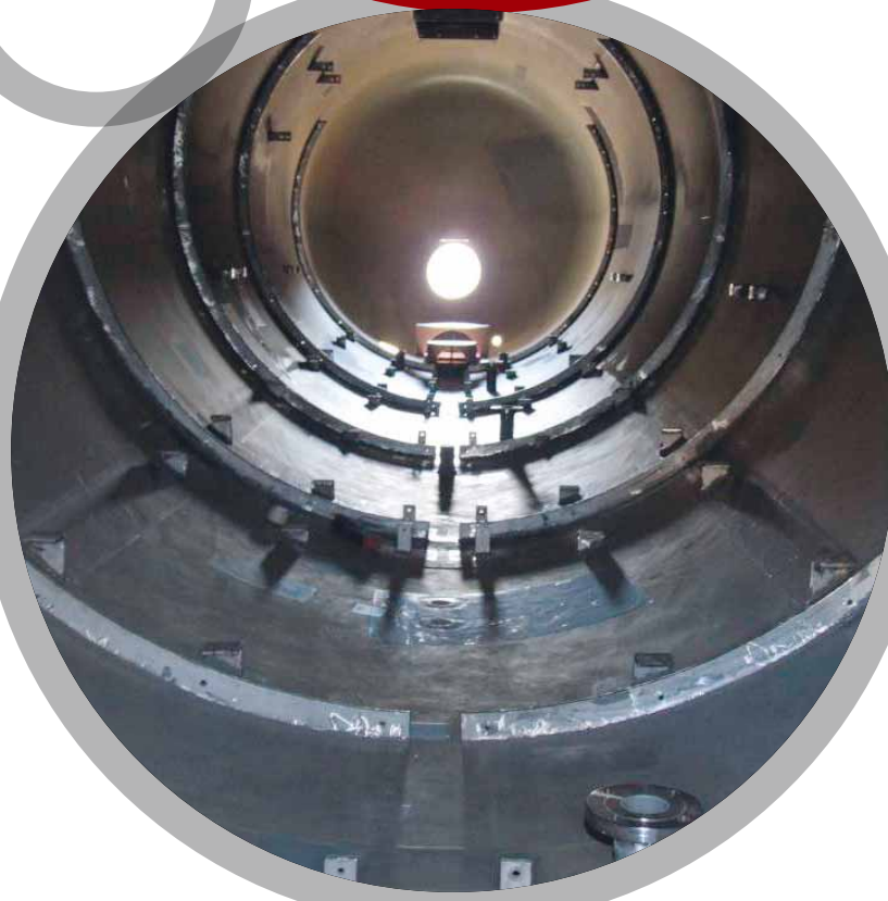
Columnas de absorción
