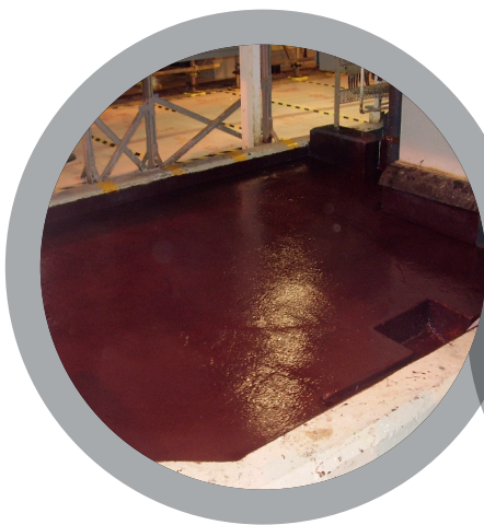
Cuves de rétention de produits chimiques
