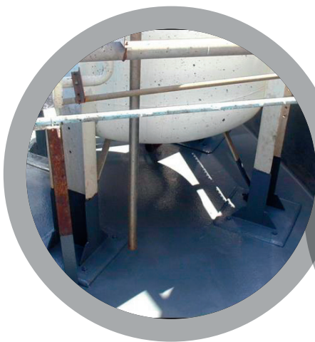
Cuves de rétention de produits chimiques
