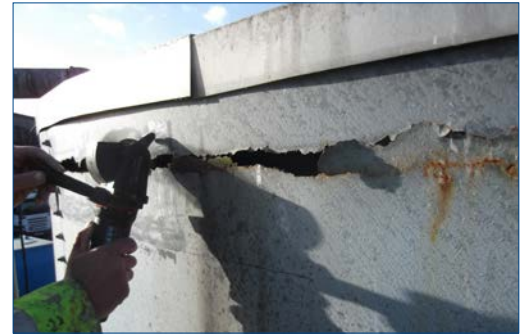
Nahaufnahme der korrodierten Stellen
